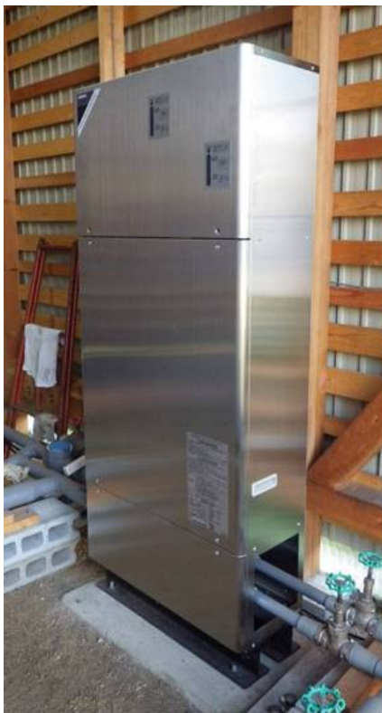
土壌加温用ヒートポンプ
