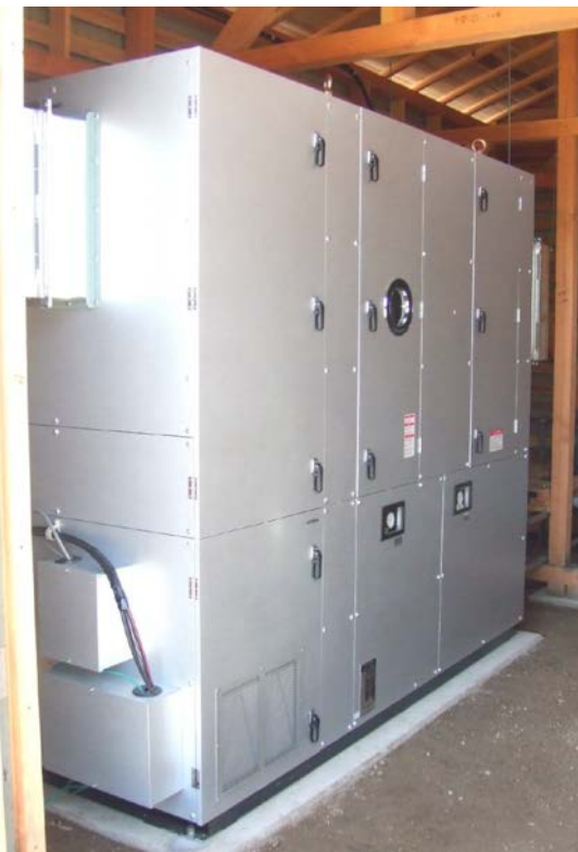
ハウス内加温用ヒートポンプ
