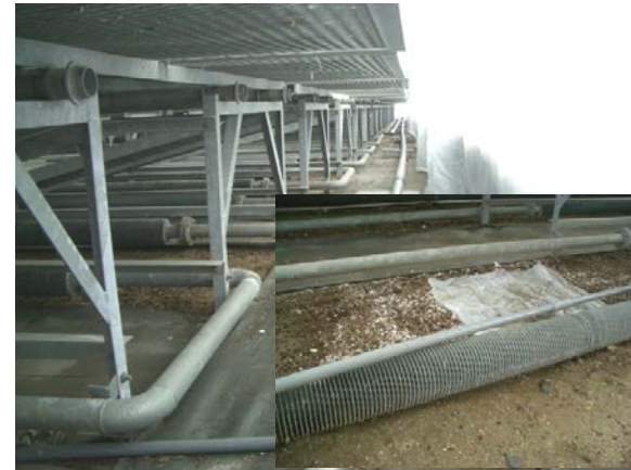
既設の放熱設備
