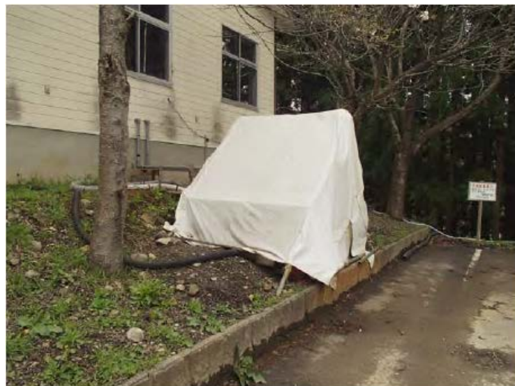
屋外 排湯槽2ton 保温ハウス
