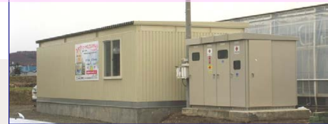
地中熱ヒートポンプ 機械室
