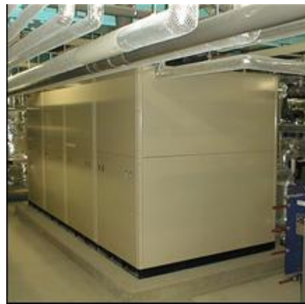
排湯熱源ヒートポンプ
