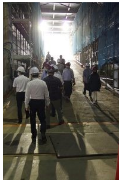
14) 搬入用車路から地上に出ます。実験ホールの床面が地表より下にあることがよく分かります。なお、リングの内側にある「中庭」へは、蓄積リングトンネルの下をくぐる通路を通らねばならず、簡単には行けないそうです。
