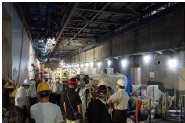
13) ライナック棟の内部です。
